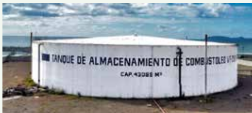
Tanque cónico de techo fijo.
